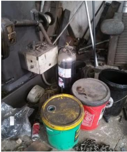
Figura 22-3. Extintores fuera de sitio
