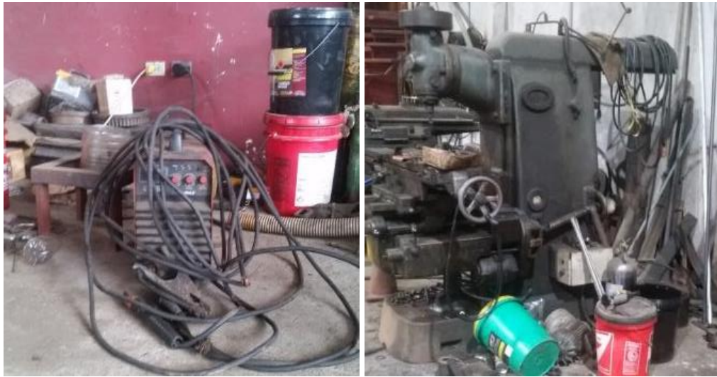
Figura 21-3. Cables sin servicio suspendidos
