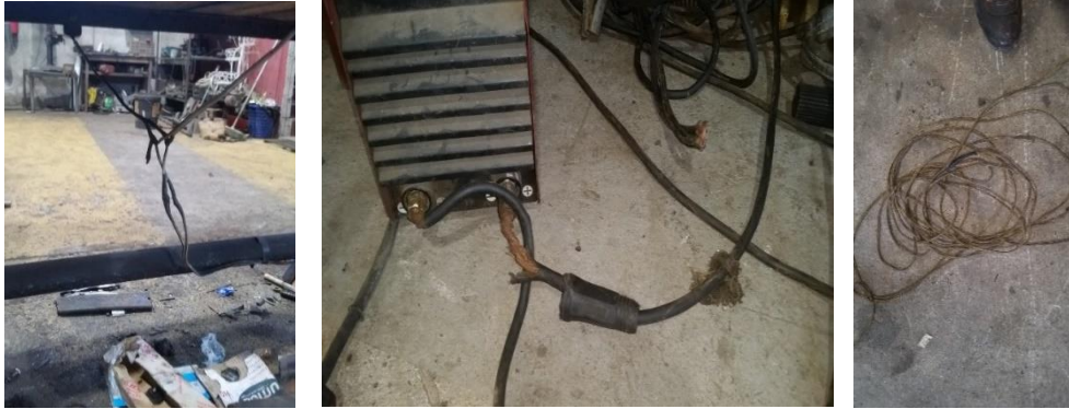
Figura 19-3. Cables en mal estado
