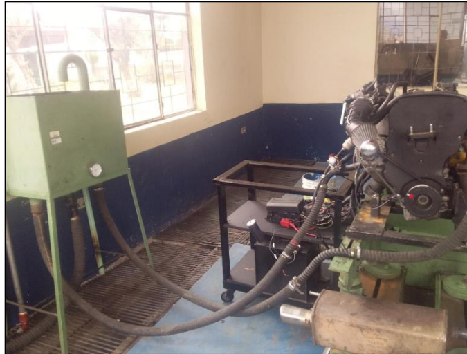
Figura 41-3: Tanque de refrigeración del motor
