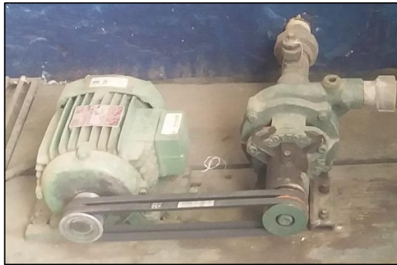
Figura 8 -3: Motor eléctrico y bomba de agua
