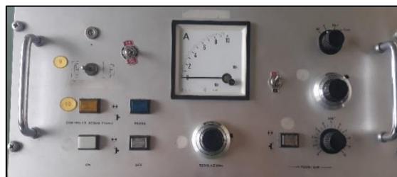
Figura. 22-3: Panel de control de cargas del freno
