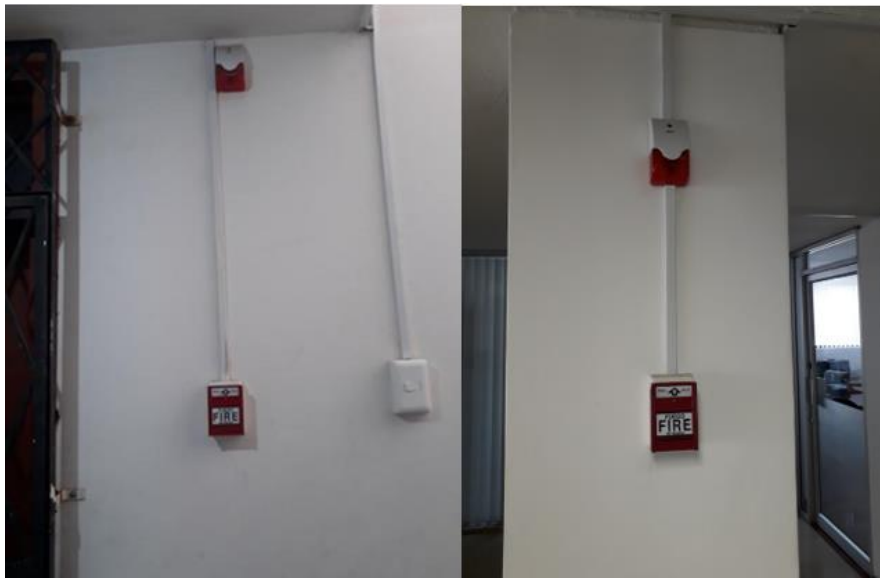
Figura 4-3: Alarmas contra incendio.
