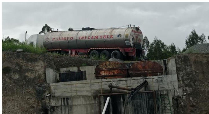
Figura 9-4: Abastecimiento de RC-250 a los tanques de almacenamiento
