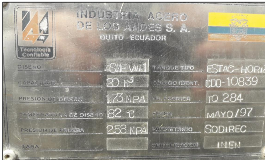
Figura 1-4: Placa de especificaciones técnicas del tanque Fuente: SODIREC
