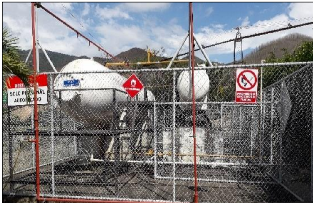
Figura 2-3: Depósito de GLP en Planta de beneficio SODIREC
