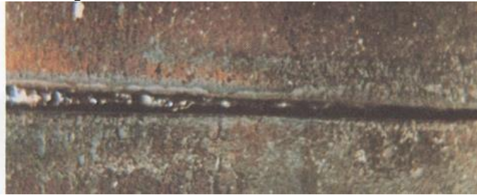
Figura 2- 32: Penetración incompleta en una junta soldada
