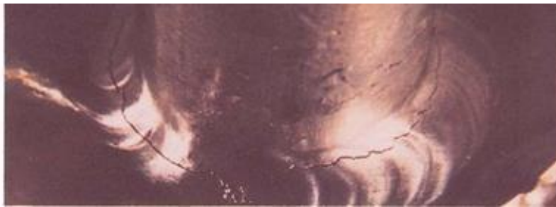
Figura 2- 34: Fisuras en un cordón de soldadura
