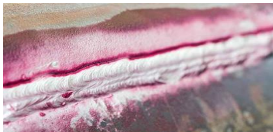
Figura 2- 38: Discontinuidades en la soldadura Fuente: Aeisa Realizado por: Borja, Darío; 2020.
