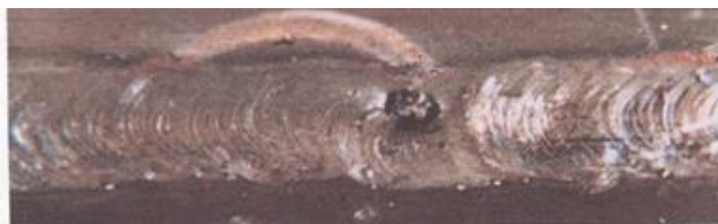
Figura 2- 35: Inclusión de escoria en un cordón de soldadura
