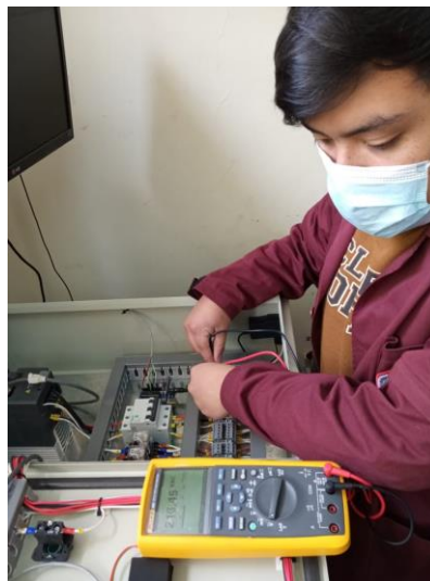
Figura 1-4: Pruebas generales eléctricas.
