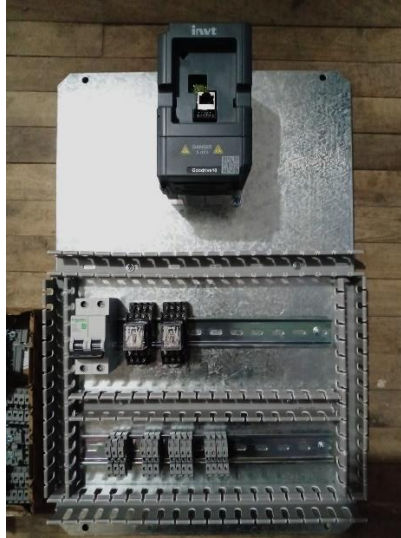
Figura 11-3: Colocación del relé encapsulado y las borneras.
