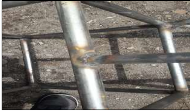
Figura 62-3: Cordón de soldadura, unión entre los tubos de la cabina.
