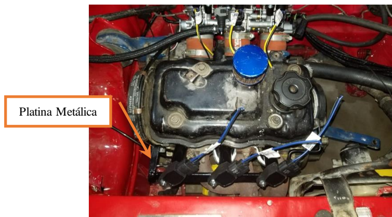
Figura 14-3: Fijación de bobinas COP Realizado por: Soto Alex, Palacios Paul, 2021
