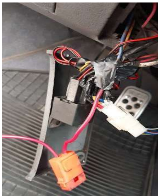
Figura 19-2: Instalación de la porta fusible
