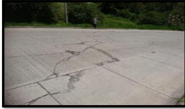
Figura 9-1: Daños en la estructura de pavimento en la ruta
