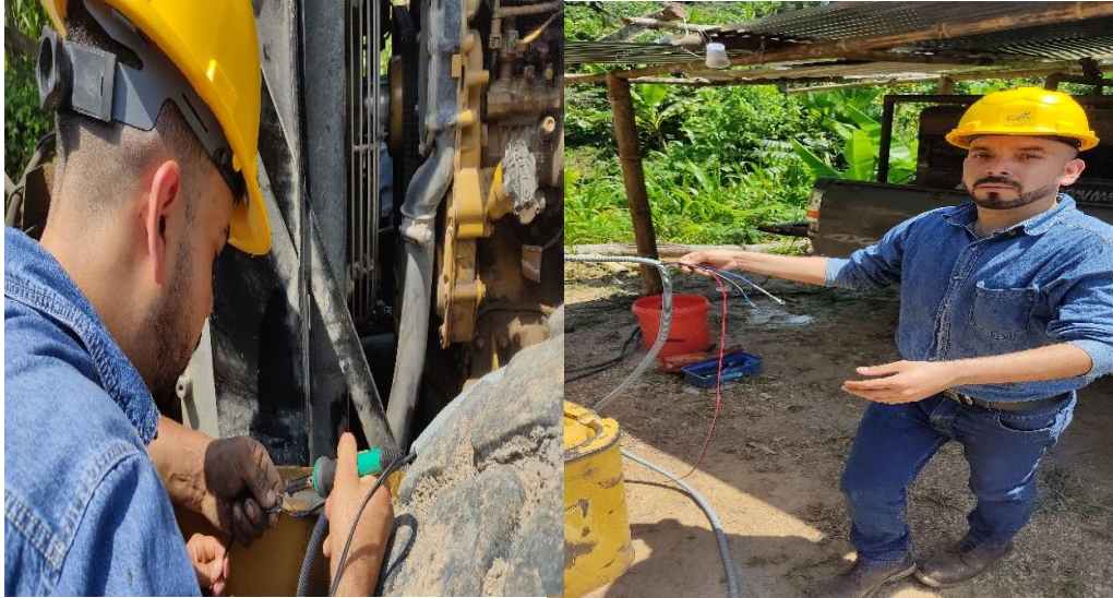
Figura 60-3: Adecuación y delimitación del recorrido del cableado de sensores
