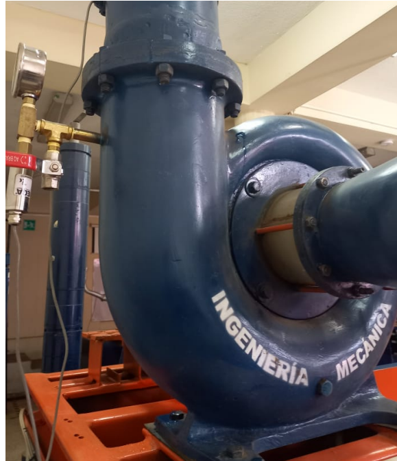
Figura 2-3: Turbina y manómetro de medición de presión
