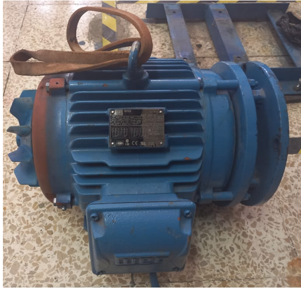
Figura 8-3: Bomba centrífuga con fugas
