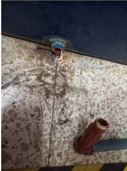
Figura 16-3: Tubería con presencia de corrosión
