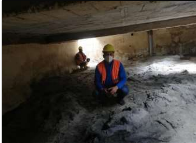
Figura 13-4. Tanques de arena del agua potable
