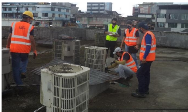
Figura 12-3: Equipos de mantenimiento; climatización
