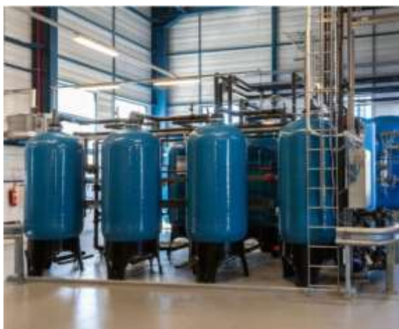
Figura 12-1: Sistema de filtración de separación con tanque de fibra de vidrio.
