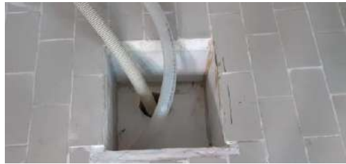
Figura 3-3: Drenajes de piso
