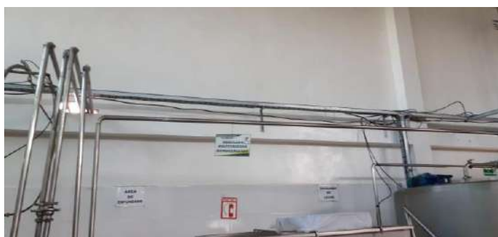
Figura 7-3: Instalaciones eléctricas y redes de agua
