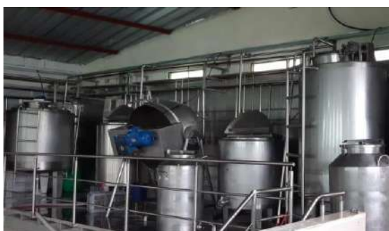
Figura 10-3: Instalaciones de los equipos
