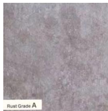
Figura 1-1. Grado de corrosión tipo A.
