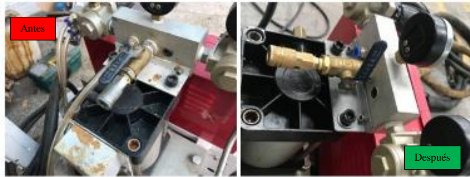
Figura 26-3. Mantenimiento de los accesorios de presión
