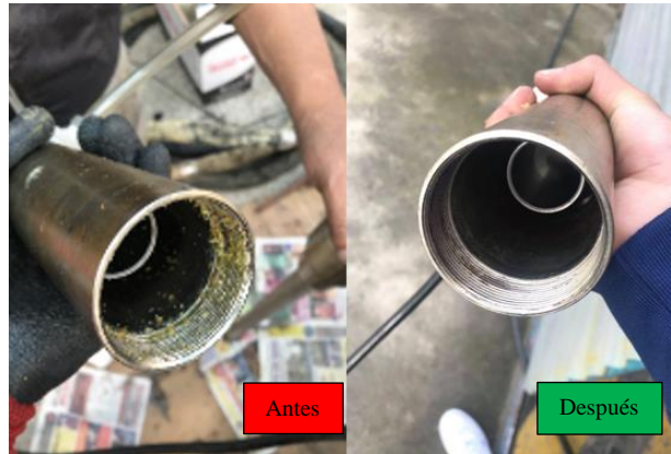
Figura 12-3. Mantenimiento de los cabezales de succión
