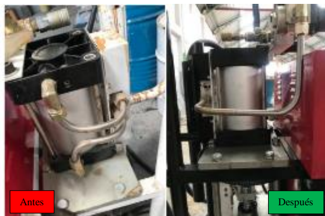
Figura 17-3. Mantenimiento del motor de gas presurizado
