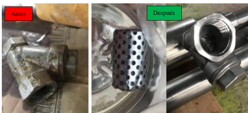
Figura 11-3. Mantenimiento de los filtros en Y
