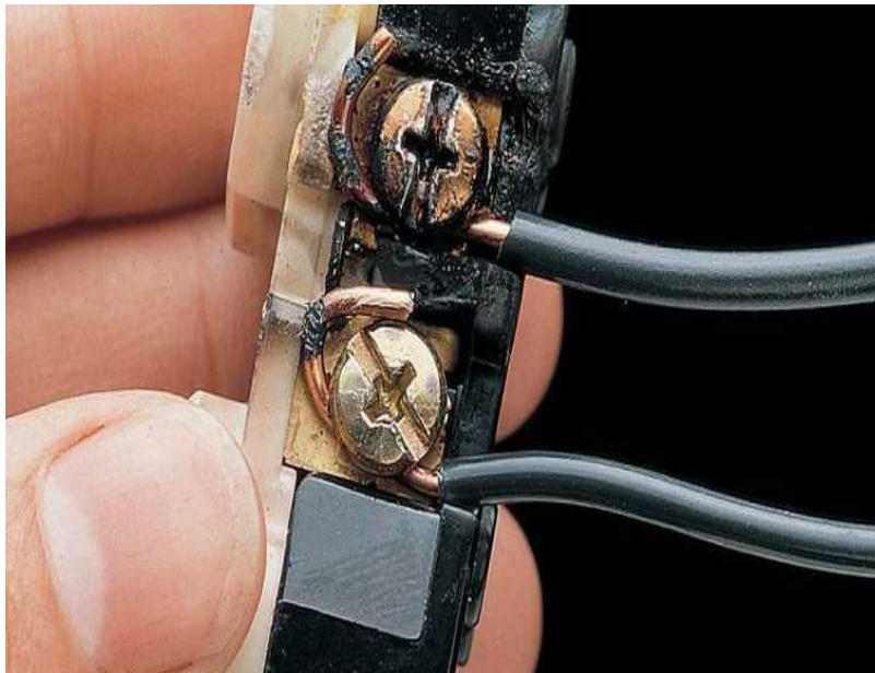
Figura 1-2: Falso Contacto Eléctrico
