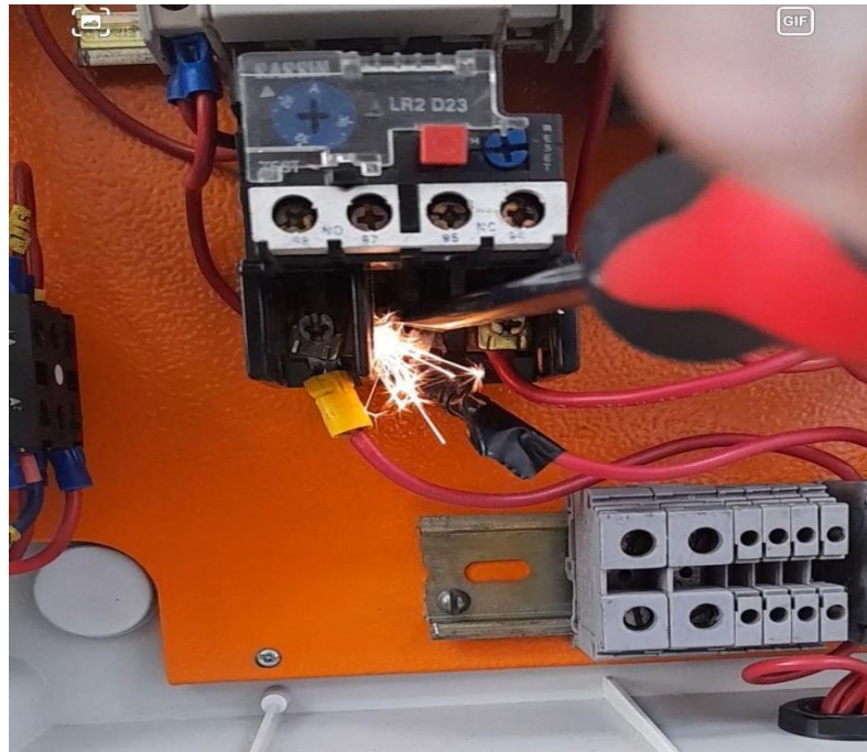
Figura 3-4: Inicio de la falla
