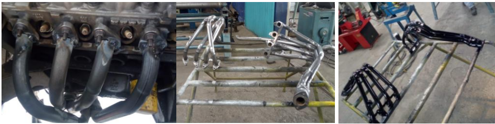
Figura 25-3: A) Soldadura eléctrica de los tubos B) pulida externa C) Pintada del múltiple terminado
