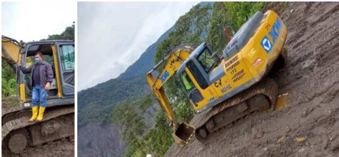
Figura 12-2: Operador 2 y obtención de datos durante su trabajo.
