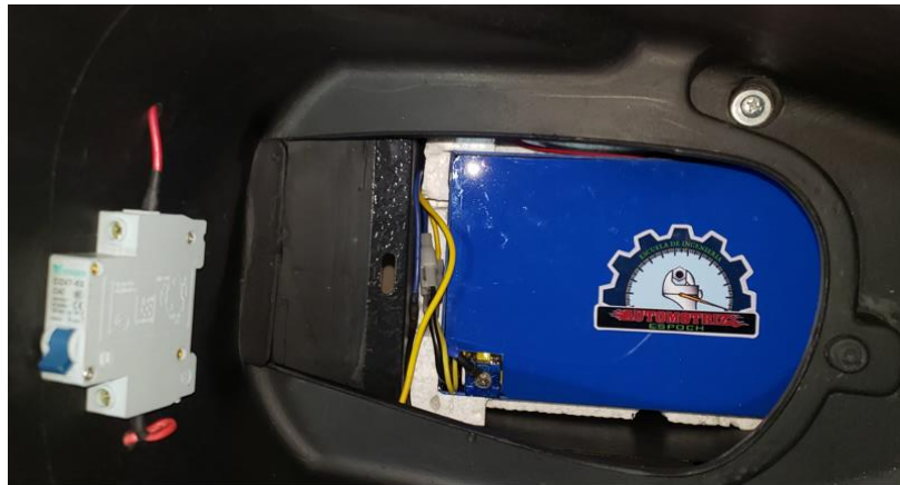
Figura 40-3: Braker de seguridad para la línea positiva de la batería
