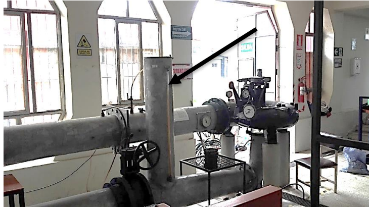
Figura 22-3: Mirilla de nivel del agua
