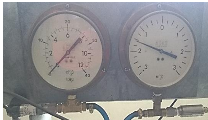
Figura 3-4: Manómetros instalados en la bomba axial
