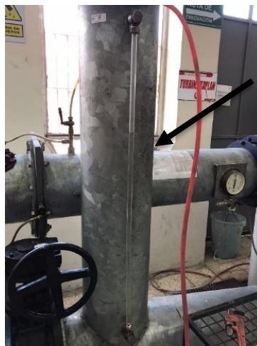
Figura 23-3: Acrílico nuevo del nivel de agua
