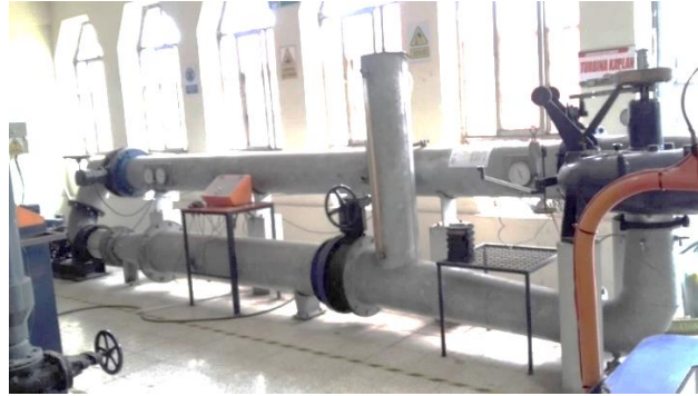
Figura 12-3: Estado de las conexiones y cableado eléctrico
