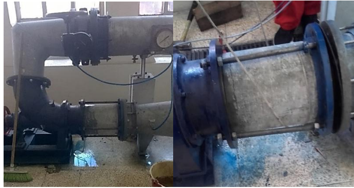
Figura 24-3: Unión de asbesto fracturada
