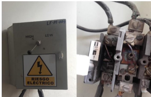
Figura 10-3: Tablero de control y relé de sobrecarga
