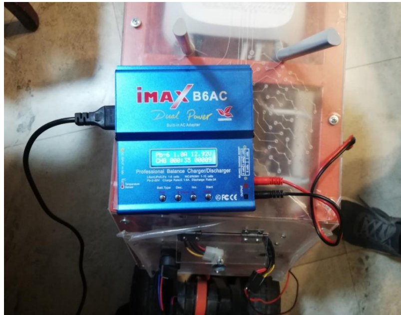
Figura 46-3: Carga de las baterías Realizado por: Villacis, A. 2021
