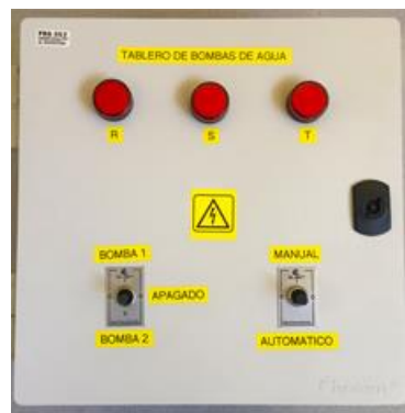
Figura 27-4: Tablero de control con botoneras identificadas
