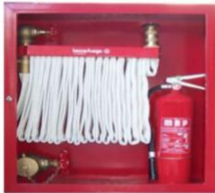
Figura 5-2: Ejemplo de un gabinete contra incendios de clase III
