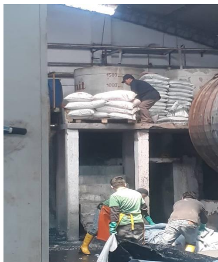
Figura 39-4: Almacenamiento en altura sin protección de barandillas
