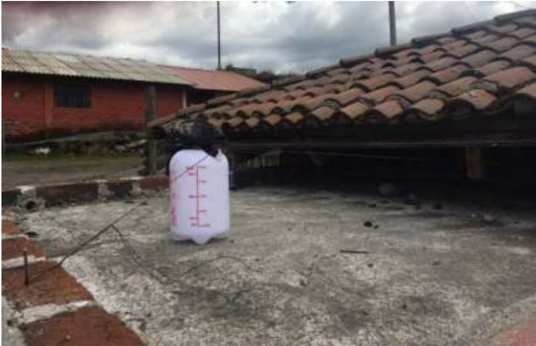
Colector Lluvia Comunidad de Santa Lucía
