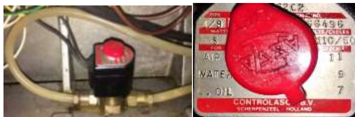
Figura 17-3. Electroválvula presenta fugas
