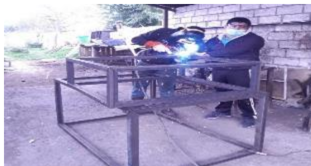
Figura 22-3: Estructura superior Realizado por: Moreno, G.; Pilco, V. 2022
