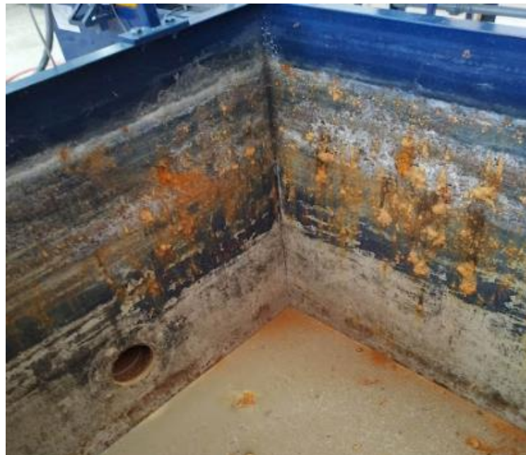
Figura 17-2: Corrosión uniforme en el tanque de almacenamiento de agua
