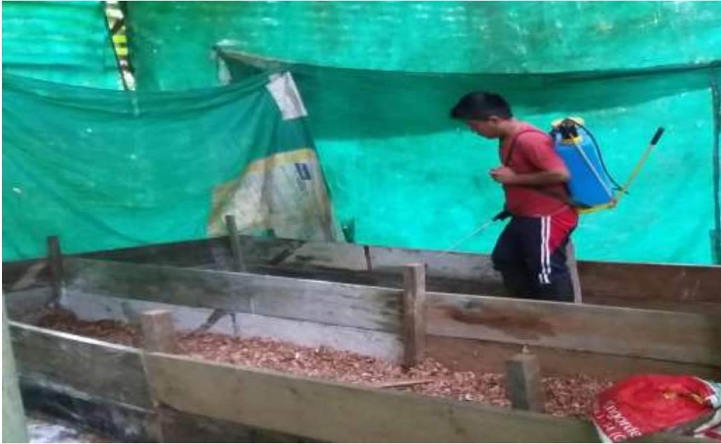
Fecha: Martes, 07/12/2021; Arreglo de las mallas e instalación del cableado para la iluminación uniforme en cada compartimento.
