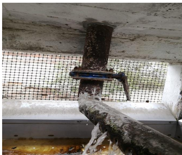
e. ingreso del agua al tratamiento
