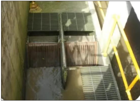
Figura 1-2. Zona de cribado - PTAR Manilla
