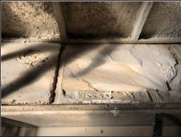
Figura 3. Cisterna que no se utiliza
