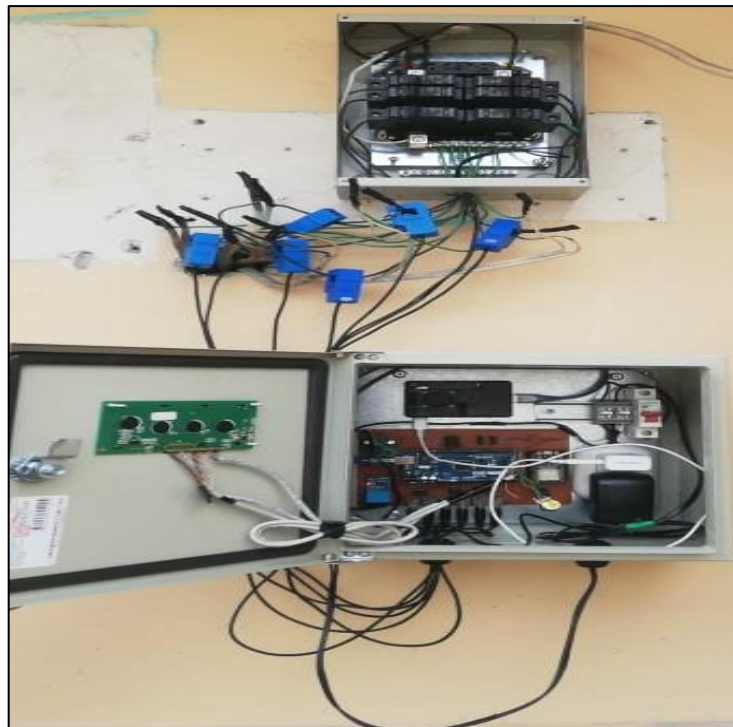
Figura 1-3. Implementación del Sistema de Monitoreo
