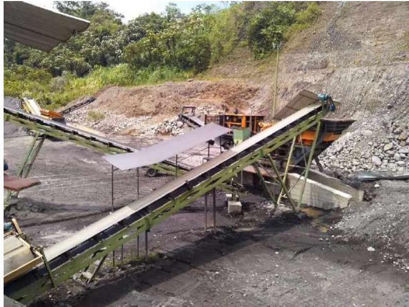
Figura 14-2: Planta de tratamiento de materiales pétreos
