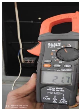
Figura 8-3: Pinza amperimétrica y termocupla
