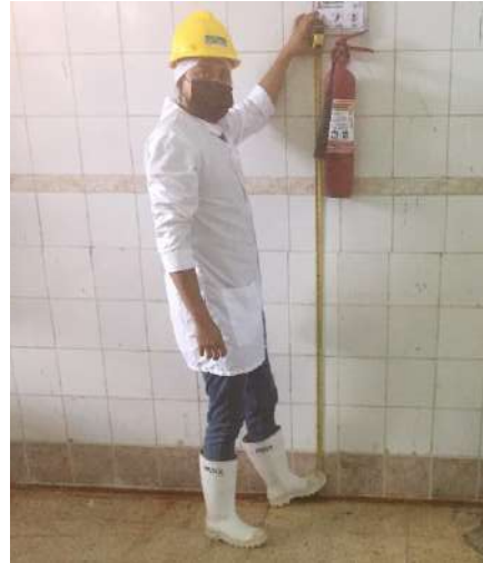
Verificación de la altura de instalación del extintor en la planta de faenamiento
