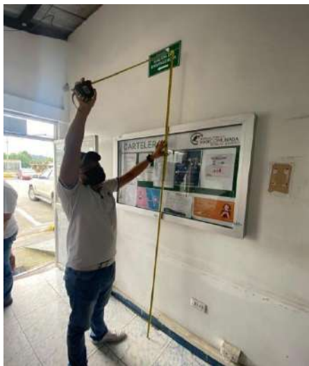
Altura de instalación de señalética
