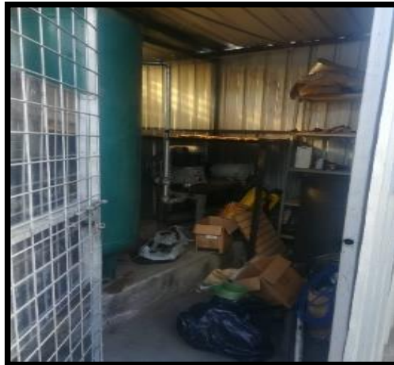
Figura 10-3: Área de Aire Comprimido
