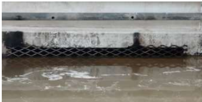
Figura 5-4: Mallas en la entrada de la campana de reboce
