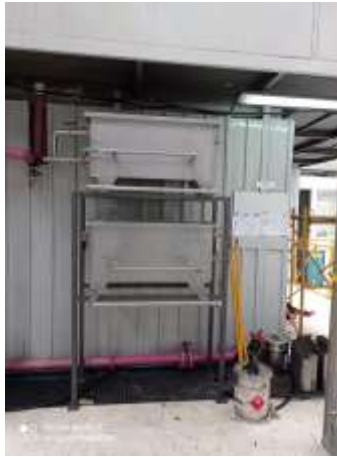
Figura 39-4: Montaje de los separadores de aceite
