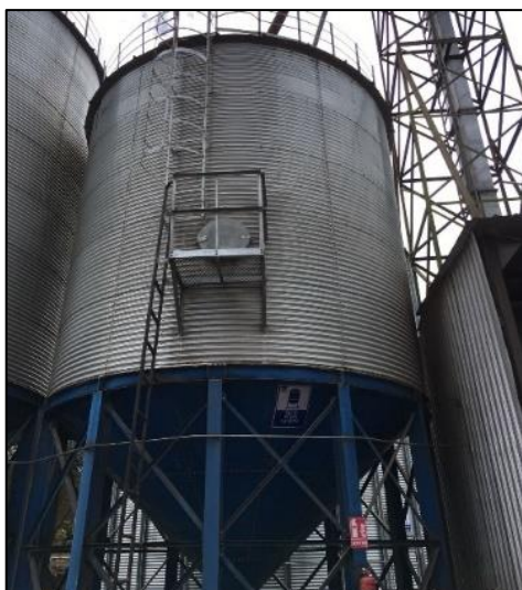
Ilustración 5-3: Silos de descarga de materia prima
