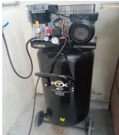
Ilustración 15-3: Compresor Realizado por: Toapanta, Paúl. 2022
