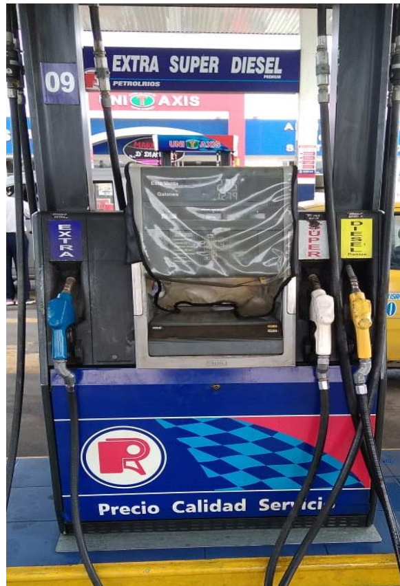
Figura 3-3: Surtidor de Combustible Elaborado por: Jiménez, J. 2020
