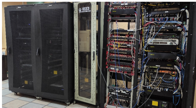
Infraestructura convergente Data Center UEB
