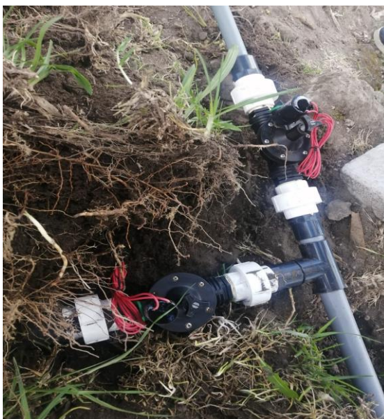
Figura 48-3: Instalación electroválvula de 1” Realizado por: Alulema, I, 2022
