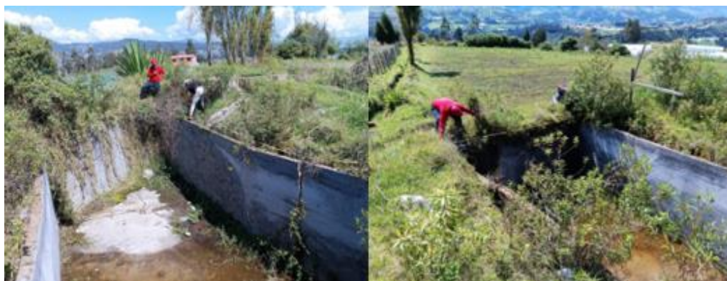
Figura 3-3: Medición tanque de almacenamiento Realizado por: Alulema, I, 2022
