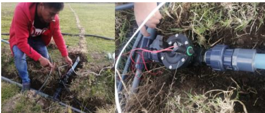
Figura 47-3: Instalación electroválvula de 1 ½"
