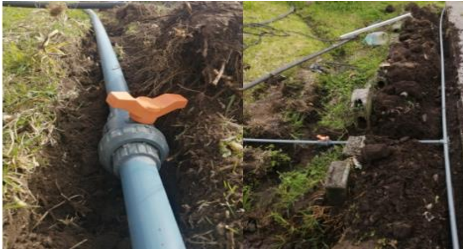
Figura 35-3: Válvulas esféricas PVC E/C TG de 40 y 25 mm Realizado por: Alulema, I, 2022
