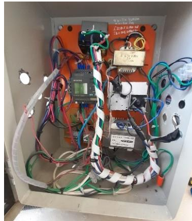
Figura 4-3: Tablero de control Realizado por: Acán, J.; Paucar, B. 2022
