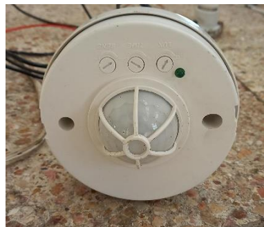
Figura 9-3: Sensor de movimiento 360° dañado Realizado por: Acán, J.; Paucar, B. 2022
