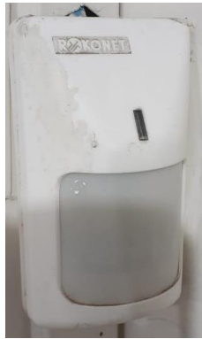
Figura 17-3: Sensor de movimiento PIR dañado. Realizado por: Acán, J.; Paucar, B. 2022
