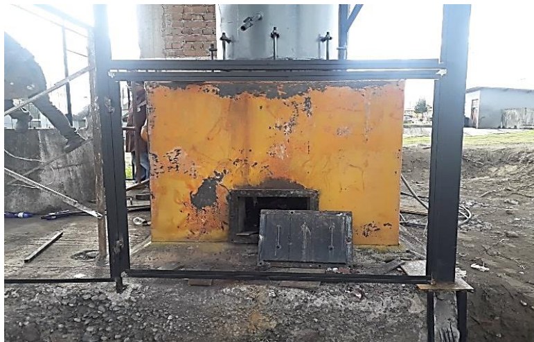
Figura 32-4: Puerta para el mantenimiento del horno.
