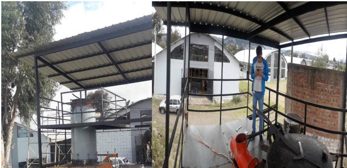
Figura 24-4: Pasamanos del gasificador
