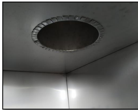
Figura 39-3: Ducto de humedad.
