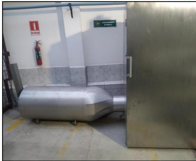
Figura 40-3: Equipo Instalado. Fuente: (López Alex, 2022)
