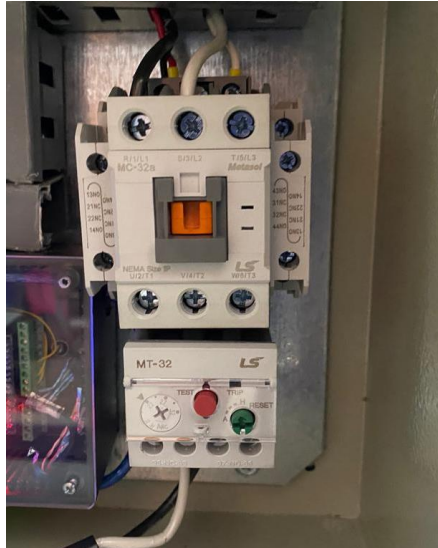
Ilustración 7-3: Contactor para control del motor eléctrico de la cortadora
