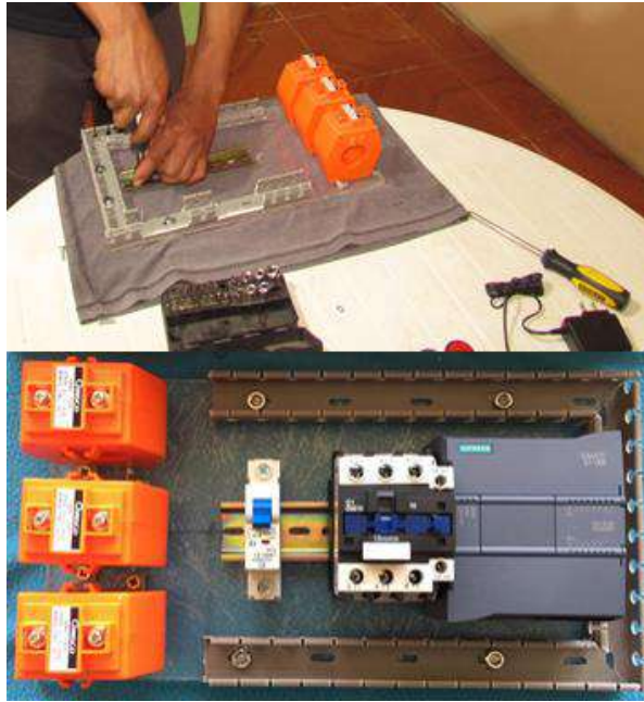
Ilustración 13-3: Montaje de los equipos sobre la base de acrílico.
