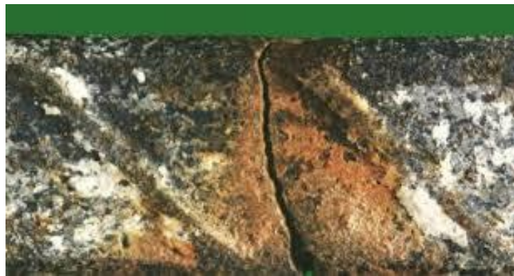
Ilustración 11-2: Corrosion por agrietamiento.
