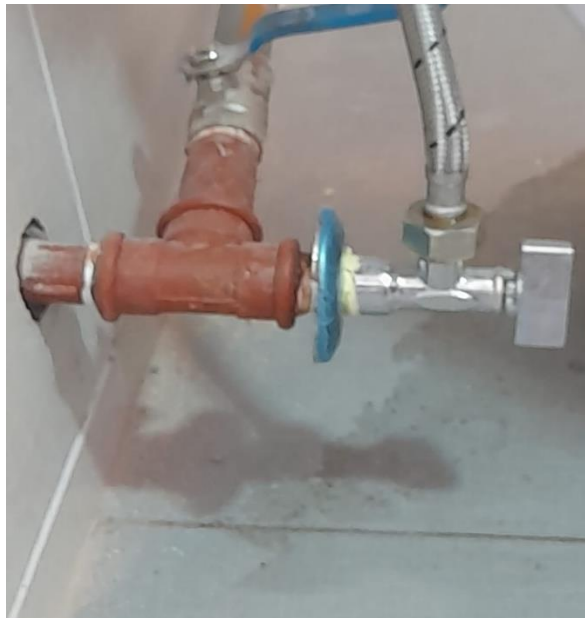
Ilustración 16-4: Toma de agua principal
